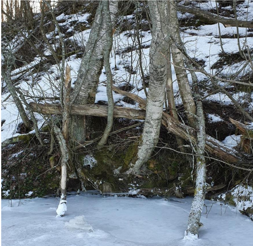
Strandslänten mot Lillån där älven eroderar släntfot och där marken hålls uppe av de träd som växer i slänten. (Bild från
