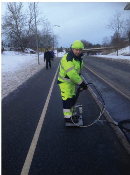
■ Friktionsmätning och saltprovtagning för utvärdering av metoden.
