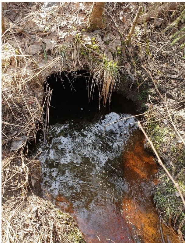
Figur 19. Punkt 1. Trumöga med diameter 800 mm i betong, utlopp vid Krossvägen. Strömmande vatten. Trumma fylld till ca 80%.
