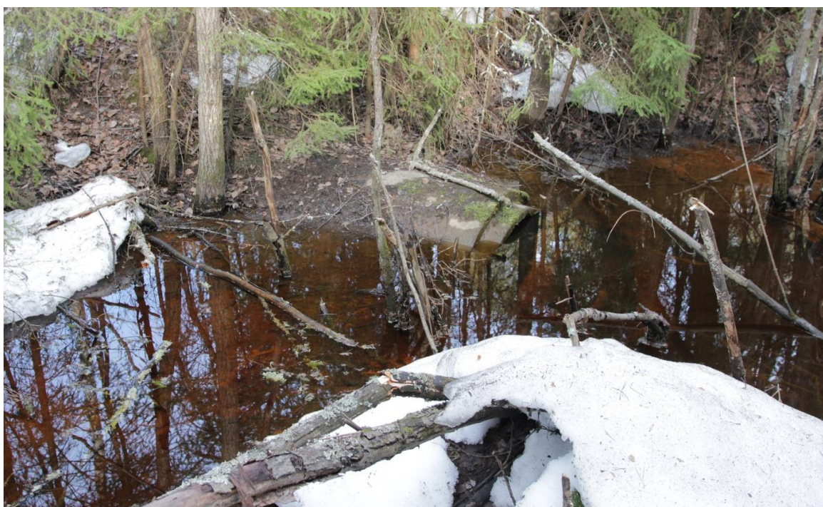
Figur 20. Punkt 2. Utlopp dagvattenledning, 1 000 mm betong vid Kolbäcksvägen. Stillastående vatten. Mottagande dike har högre dikesbotten längre nedströms vilket kan vara en av flera orsaker till dåmt utlopp.
