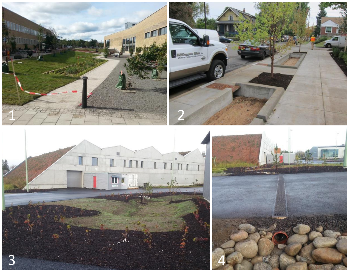
Figur 5-3. 1) Anläggning för lokalt omhändertagande av dagvatten på campusområdet. 2) Exempel på dagvattenmagasin under uppförande mellan gata och trottoar. 3) Anläggning för lokalt omhändertagande av dagvatten vid reningsverket på Ön i Umeå. 4) Dagvattenränna där dagvattenstråket kan korsa vägbanan. Dagvattenrännan fungerar även som avvattning för vägen. Källa: Sweco.
