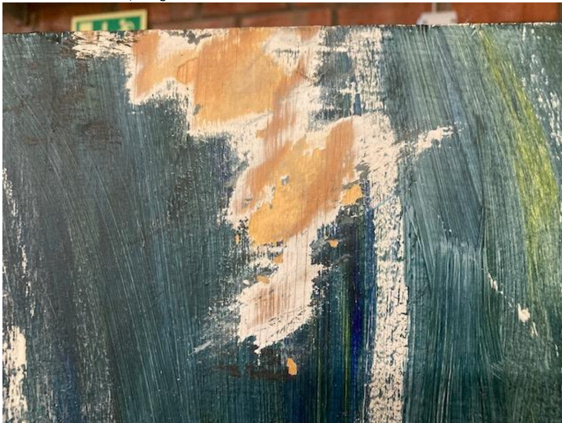
81600 Jan-Eric Ohlzon, slitageskador
