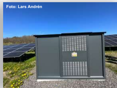
TRANSFORMATORSTATION MED WIFI
