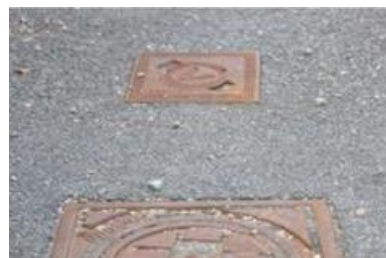
Avstängningsventil (överst i bild)
