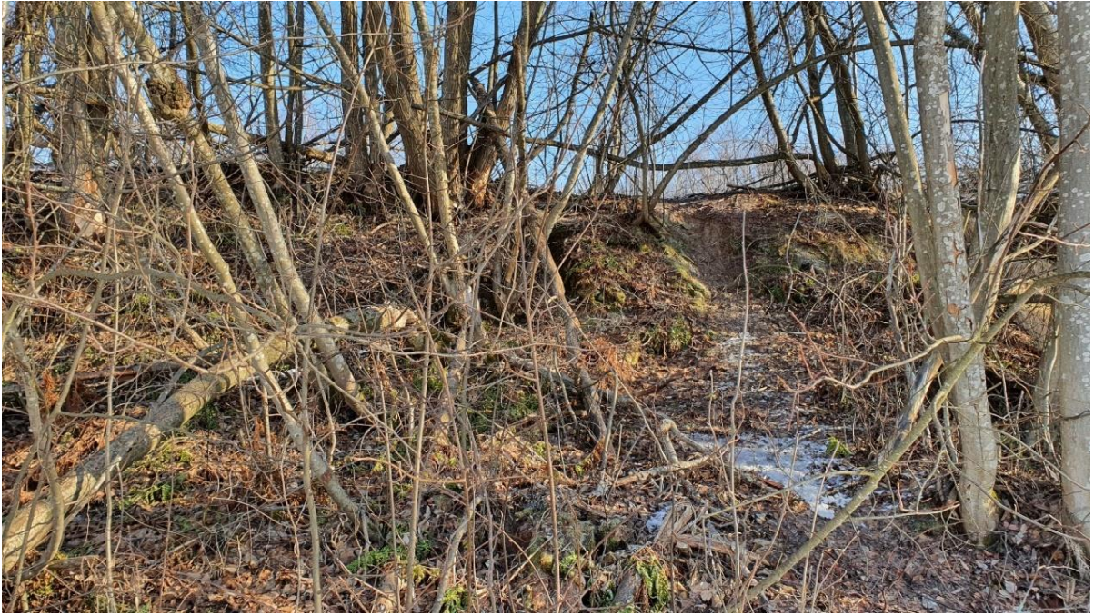
Figur 6. Exempel på erosion i slänten p.g.a. ytavrinning.
