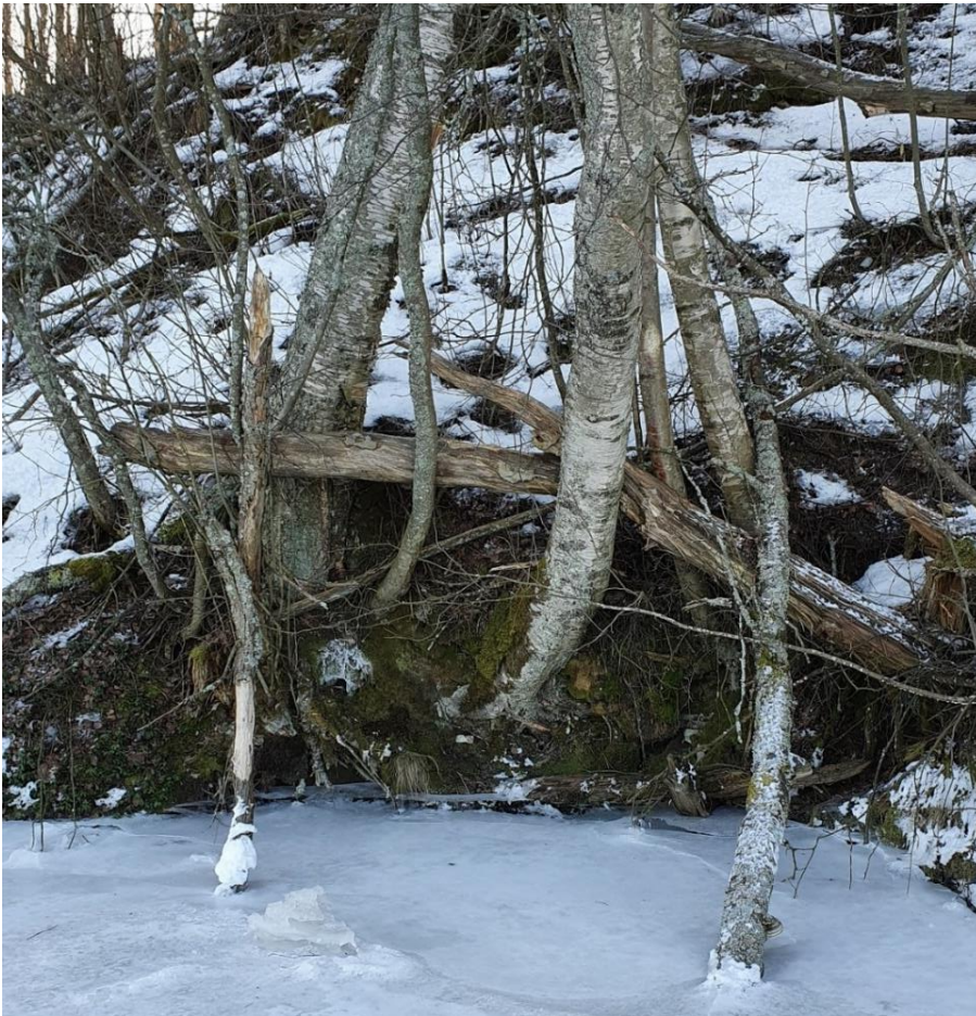
Figur 7. Exempel där älven eroderar släntfot, marken hålls ännu uppe av de träd som växer i slänten.
