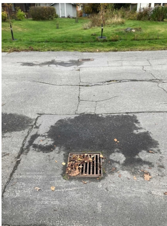
Figur 14. Dagvattenbrunn i Byvägen. Källa: Tyréns Sverige AB.
